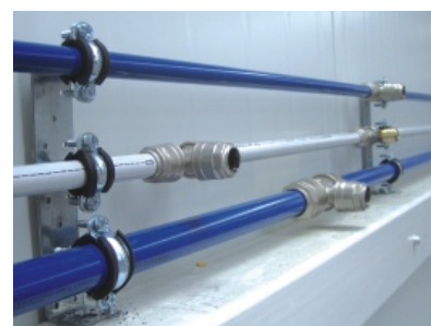
Instalacje pneumatyczne z firmie Ferrpol, 2008
