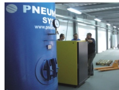
Instalacja pneumatyczna w Drukarni Kea, 2008
